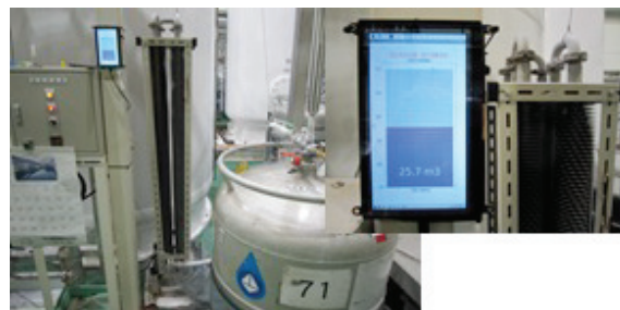
写真 3 ガスホルダーのレベル監視
