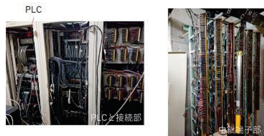
写真 1 現システムの配線
