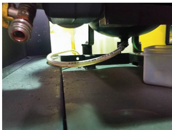
図3 オイル抜出口は狭く作業しづらい
