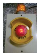
写真2 非常停止ボタン
