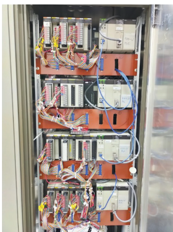
図 3. 通信機器室の計測シャッター制御ラック
