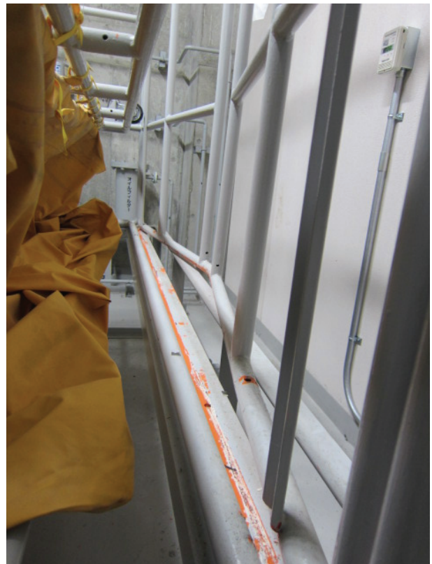
図3 鉄棒湾曲のため、棒ごと固定ネジが破断
