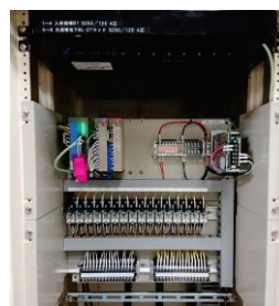
写真 9 光源加速器側データ伝送システム
