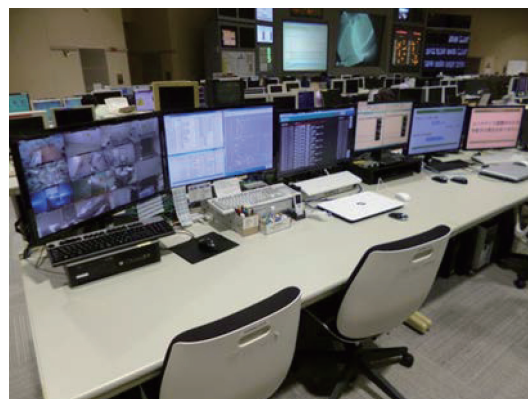
図 7. 制御室の監視 PC
