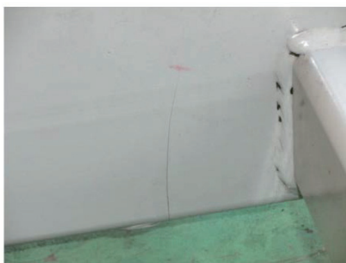
図2. 亀裂発生発見時の写真
