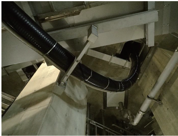
図9. 超伝導バスラインが本体室へ向かう様子
