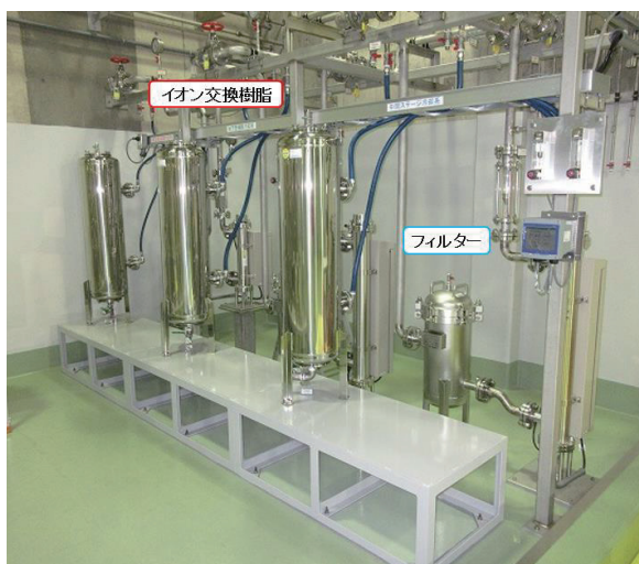
図3 移設後の純化設備
