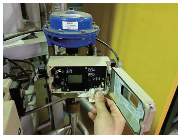
図 1. 故障した圧力制御弁ポジショナー
