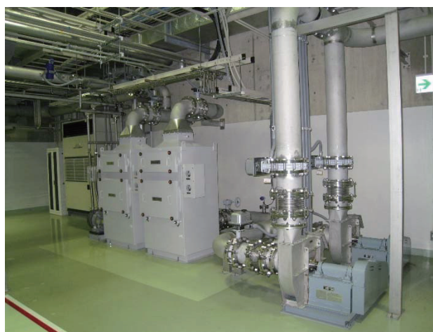
図 6. フィルタユニットと送風機
