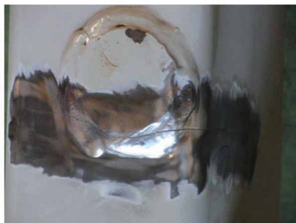
図3. 亀裂発生箇所写真
