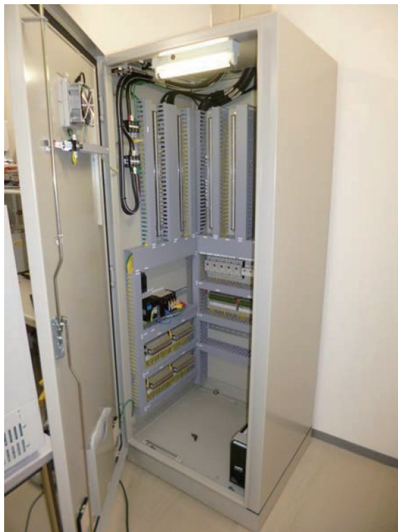
図5. インターロック盤の内部
