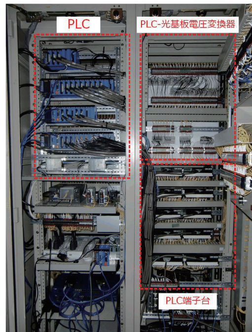
図4. CP2 盤内機器 (改造後)
