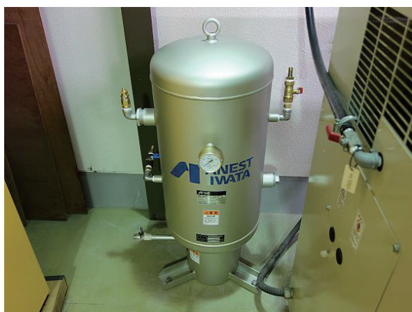
図6. 新設したバッファタンク
