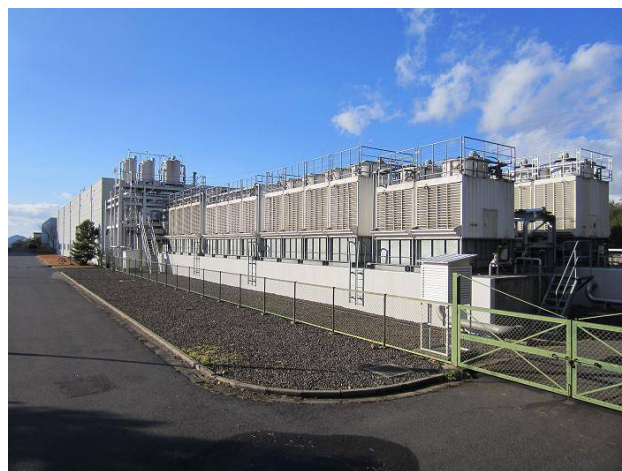
図1. 本体冷却装置冷却塔の外観
