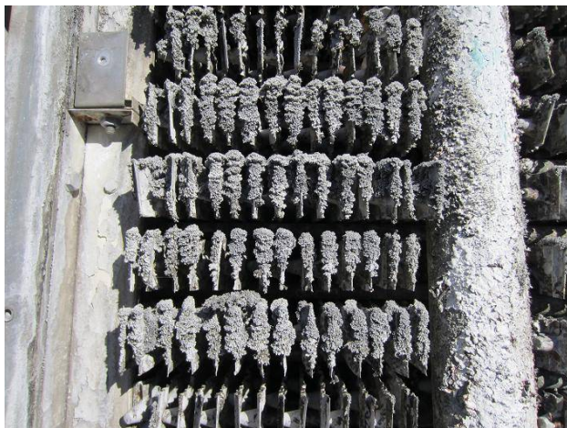
図 3. 冷却塔スケール付着状況
