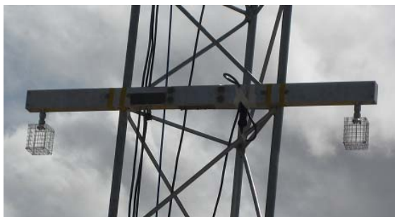
写真2. タワーへ設置されたセンサー
