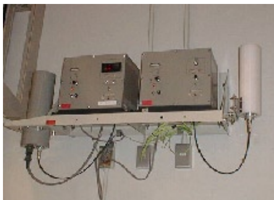
図3-3-4 本体実験棟内の放射線測定器 (写真)
