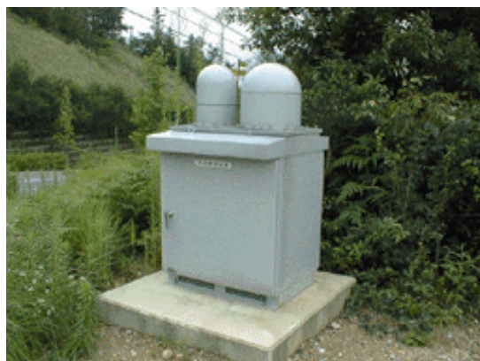
図3-3-2 敷地境界モニタリングポスト (写真)
